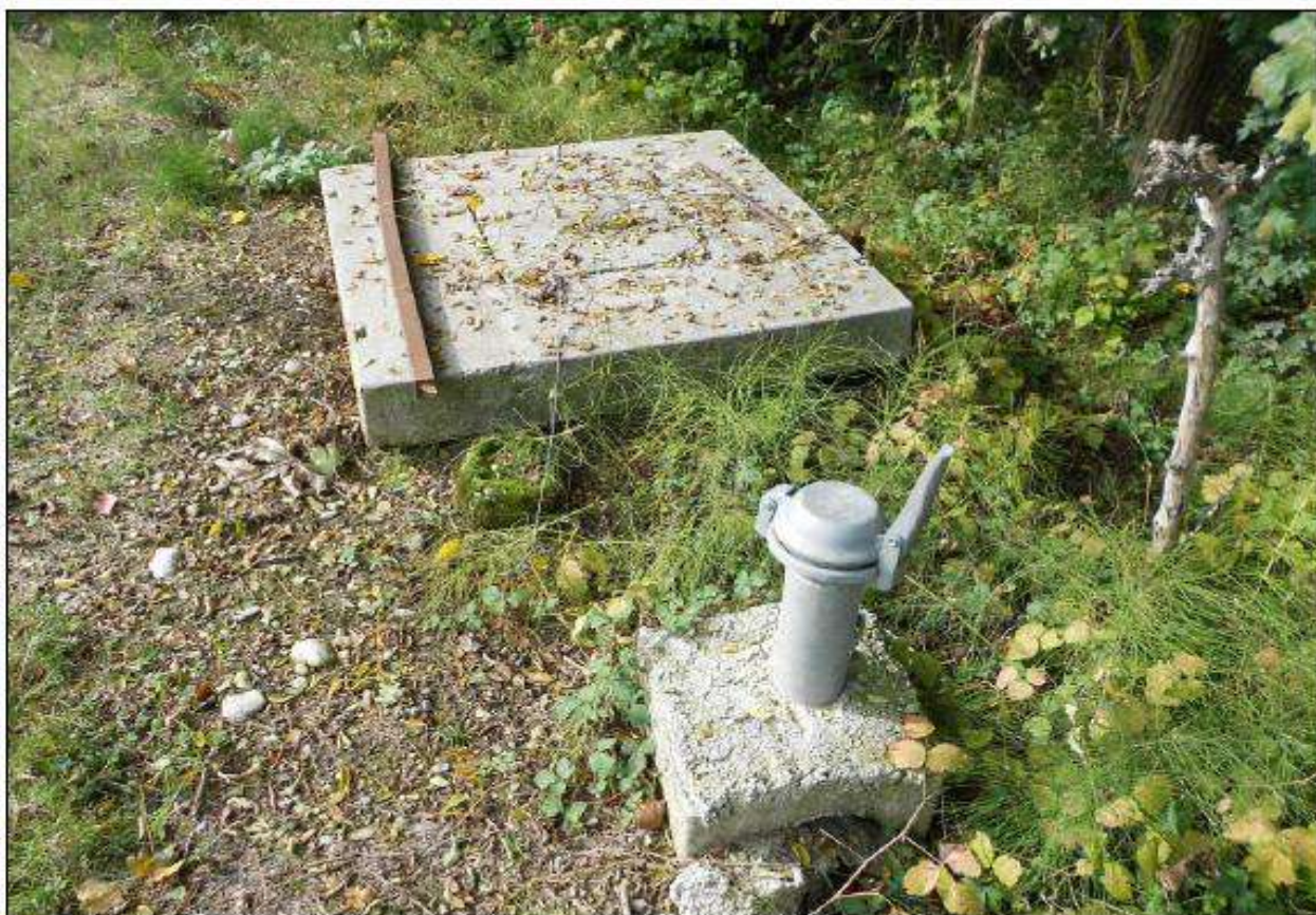
Fig. 3.17- Opera di captazione della risorgiva in località Le Chiezze presso il Molino Saccon
