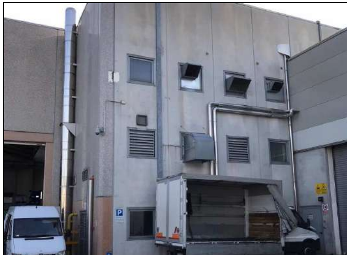
Figura 8 - Imbocco di canali di trattamento aria
